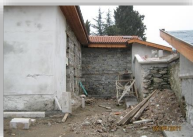
Şakülü düzeltilen cami duvarı...
