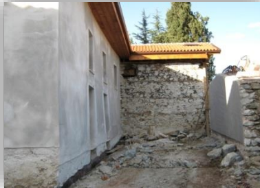
Şakülünde olmayan cami duvarı...
