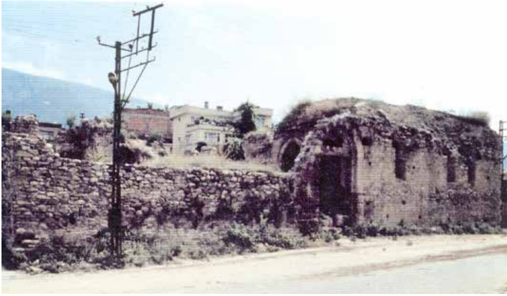
Yıldırım Darüşşifası onarımdan önce
