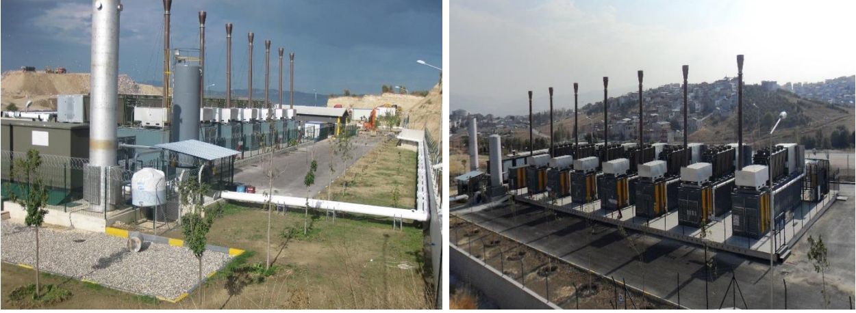
Fotoğraf 3-4 Enerji üretim tesisi
